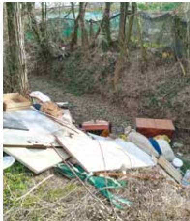
Il canale ostruito
